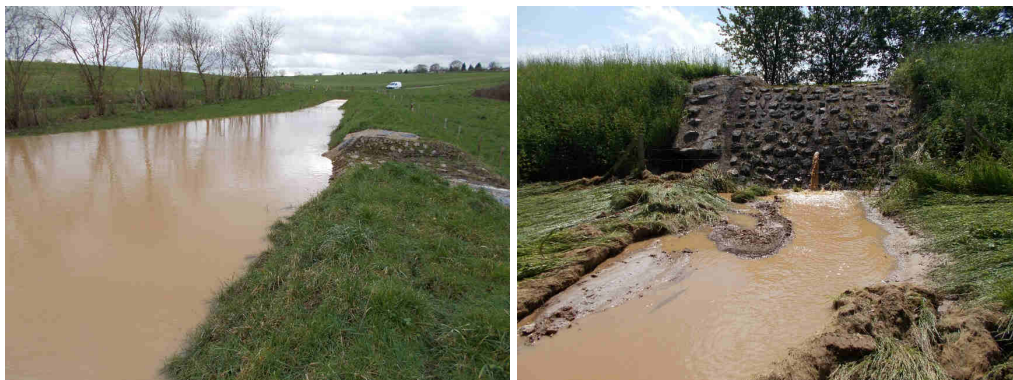
Figure 13: photos des dégradations de l'ouvrage 50
