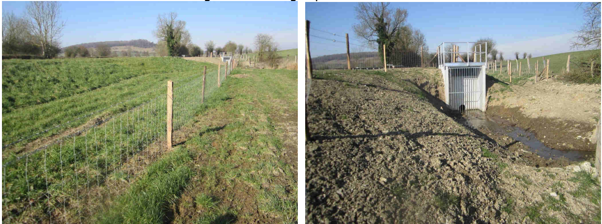
Ouvrage BIEVZEL22 finalisé et fonctionnel
