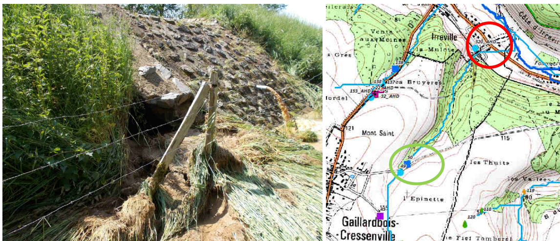
Figure 14: le cercle en vert correspond à la zone d'agrandissement de l'ouvrage n°50 et en rouge le secteur touché par les inondations.
